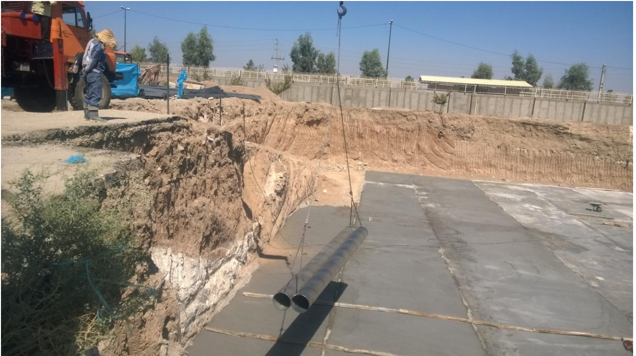
باراندازی لوله های شستشو و خروجی
