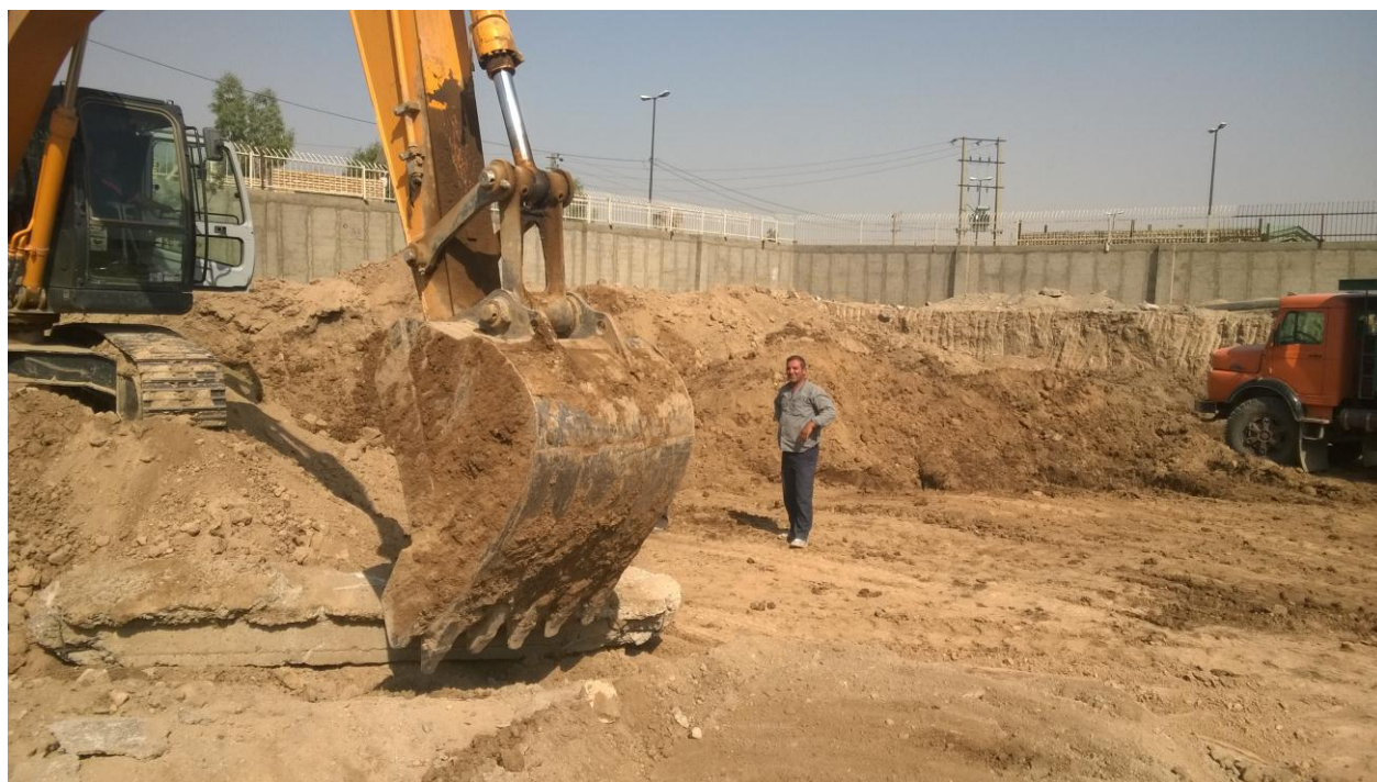
تخریب سناژ بتنی دیوار قبلی
