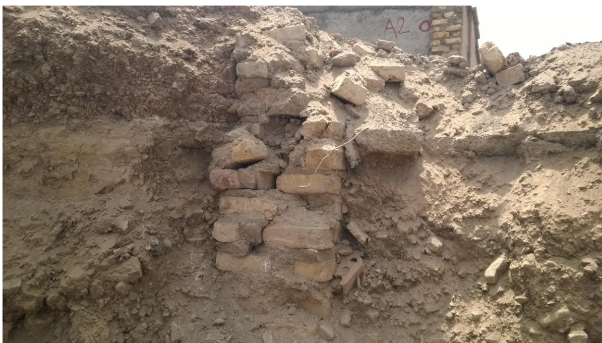
تخریب دیوار آجری در محدوده خاکبرداری
