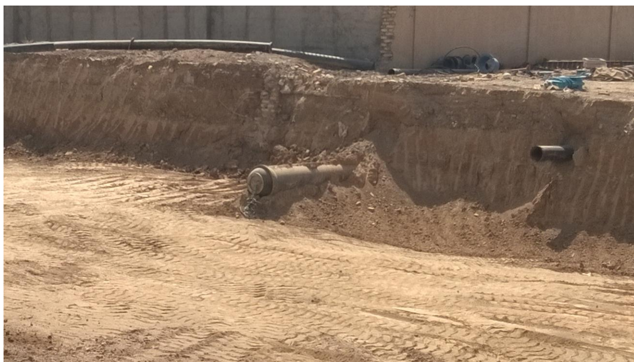
توپی استفاده شده جهت مسدود نمودن لوله
